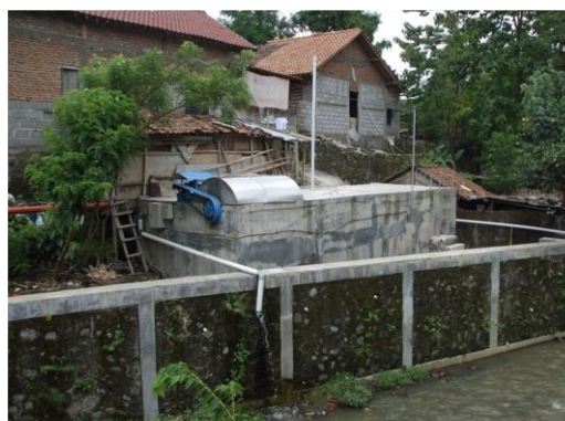
嫌気性処理と好気性処理(回転円板)を組み合わせたコミュニティ排水処理設備
