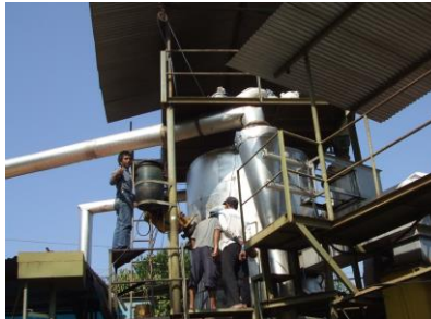
実証テストプラント(ガス化炉/再生塔)
