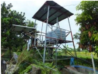
ソーラーウォーターポンプシステム
