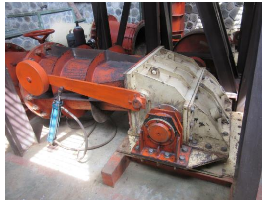
Cintamekar 水力発電所(タービン)
