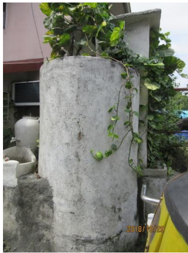
公衆トイレに併設された雨水タンク(上)と排水処理設備(右)
